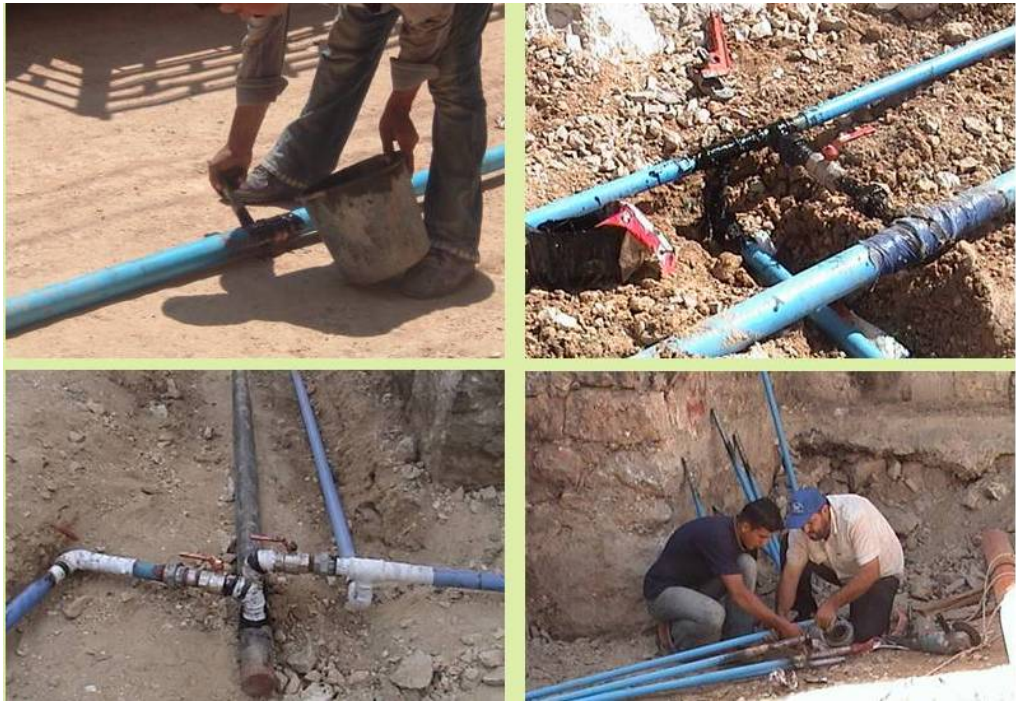
صورة (١٠) شبكة تزويد المياه في البلدة القديمة
